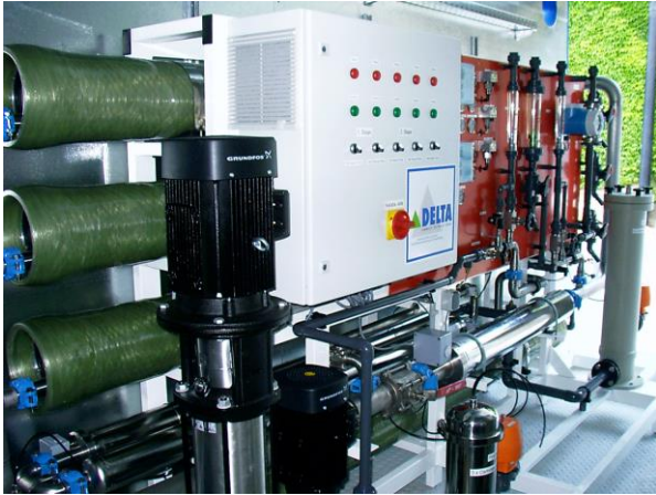
Umkehrosmoseanlage in Rumänien
